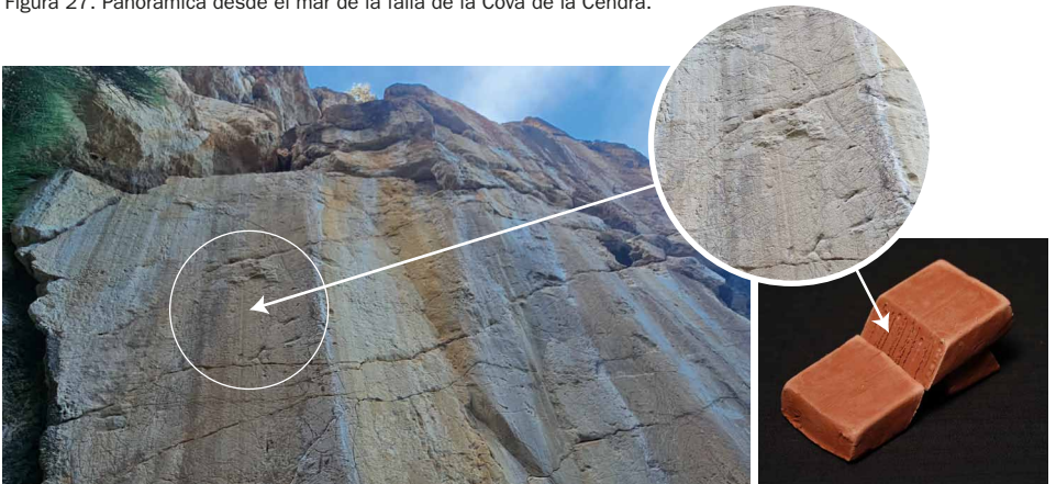
Figura 28. Una forma de reconocer esta superficie de falla es que la pared está estriada. Las estrías son pequeños surcos o arañazos producidos por la enorme fricción provocada por el movimiento entre los dos bloques de falla.
